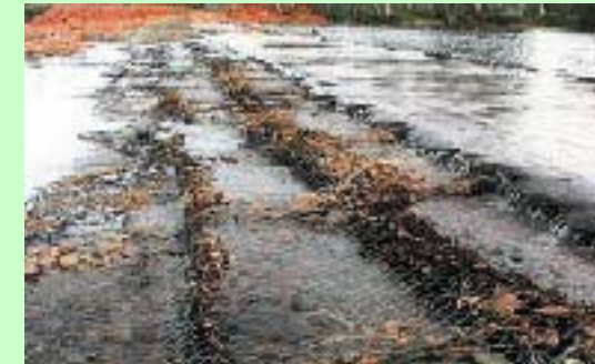
Australie- cette chaussée était régulièrement endommagée par les inondations. Les gabions furent souvent perturbés
