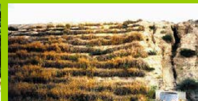
Espagne- un remblai d'autoroute non stabilisé utilisant le SV. A droite, un remblai érodé non traité. Exemple de SV sous un climat méditerranéen à faible pluviométrie.
