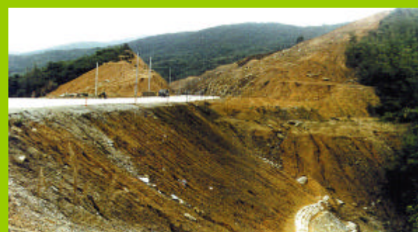
Chine- remblai d'autoroute non stabilisé avant le traitement avec le SV. Avant le traitement, la stabilité de la route était si mauvaise que d'importants craquements latéraux s'étaient produits au niveau du pavage
