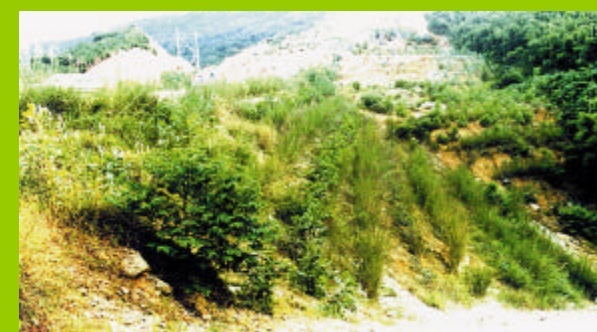
Chine- le même remblai un an plus tard. Deux années plus tard, ce remblai fut totalement recouvert de forêt. La partie blanche en arrière-plan représente la zone qui n'avait pas été traitée
