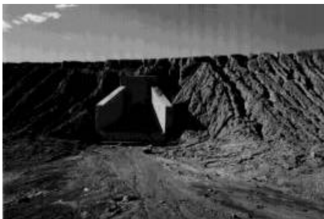
Erosión Pista Sub – Urbana
